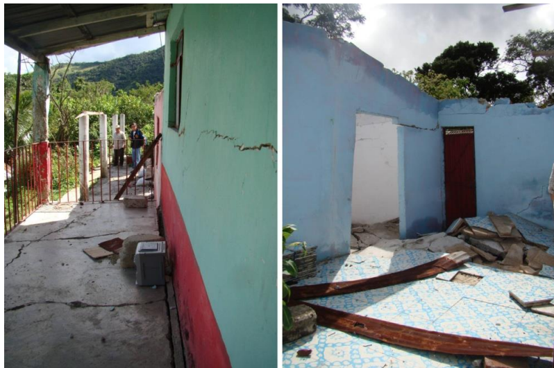
Figura 5. Daños ocasionados en las viviendas de la comunidad de Rincón de Negros, municipio de Alto Lucero, Veracruz por el proceso de reptación ocurrido en junio de 2013.
